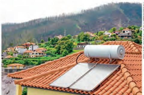
Nos painéis de aquecimento solar, há captação e transferência de calor para a água, que é aquecida.
